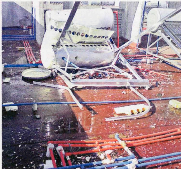
Durante un recorrido por el conjunto aún se pudieron apreciar restos de la explosión y otro de los calentadores tenía un tubo roto.
